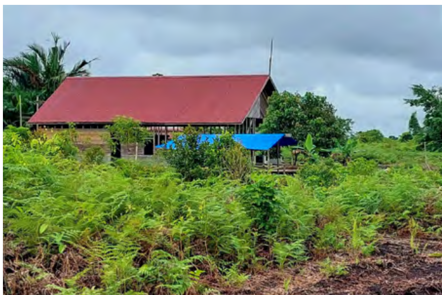
In der Siedlung Mungkal an der Ostküste Sumatras – in einem Torfmoorgebiet am Rande einer Ölpalmenplantage – entsteht zurzeit neben dem noch unfertigen Kirchengebäude der HKBP (mit rotem Wellblechdach) auch ein Gemeindehaus. KED-Referent Andreas Kurschat deutete in seiner Gastpredigt an, wie die aus der Missionstätigkeit Nommensen hervorgegangene HKBP dort nun ihrerseits missionarischen Dienst leistet.
